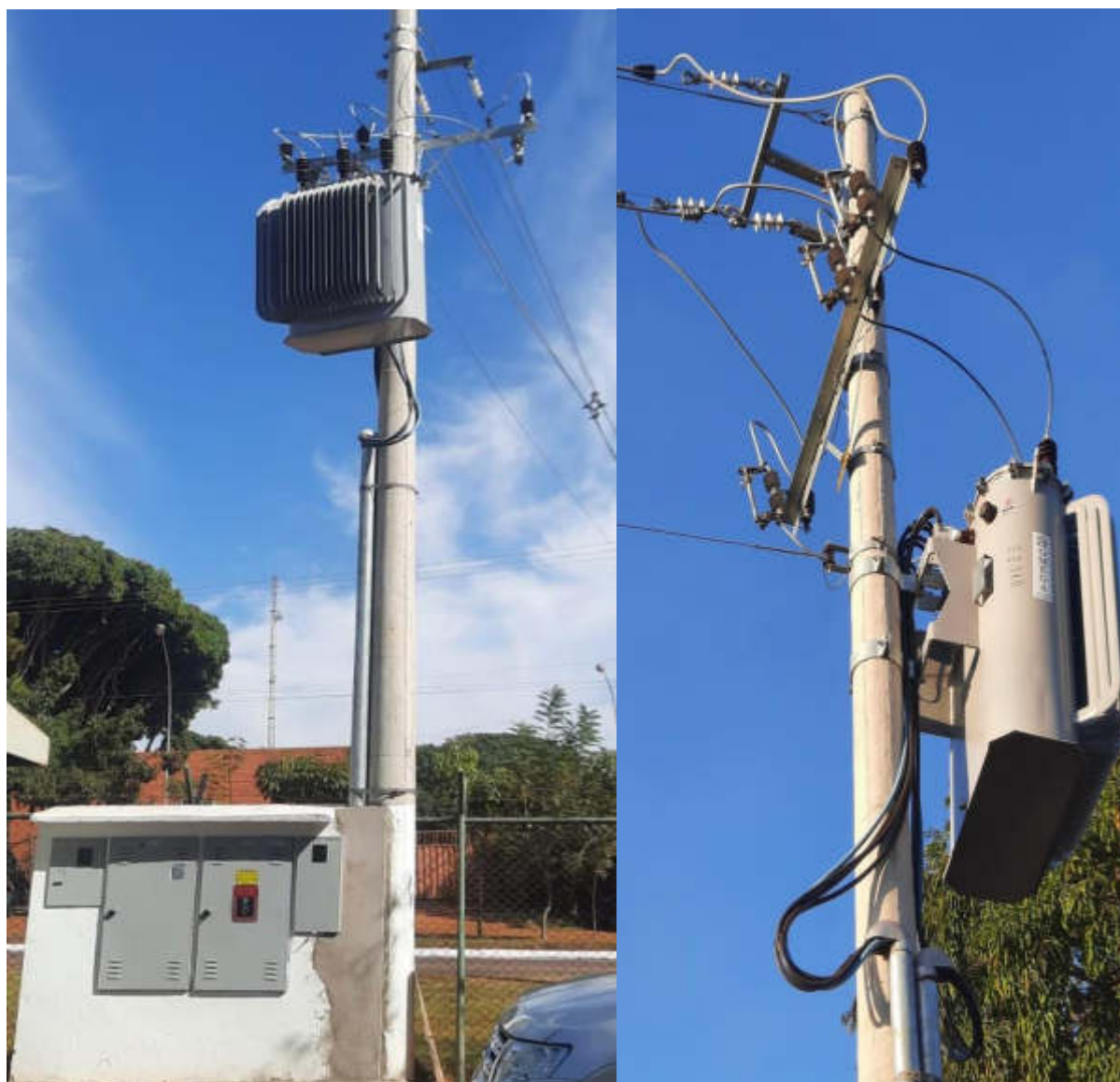
Figura 15 – Subestação aérea existente.
