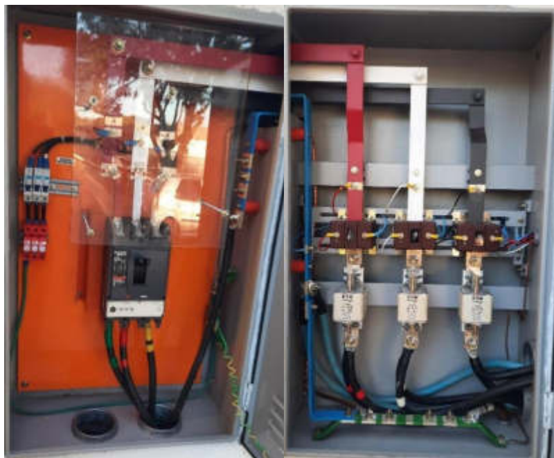
Figura 16 – Vistas internas dos quadros da subestação de entrada situados na mureta de proteção e medição.
