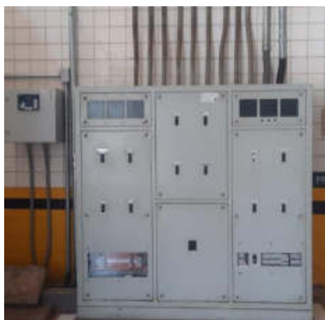
Figura 9 – Foto da parede de instalação dos equipamentos (QDCA, inversores e caixas de junção).
