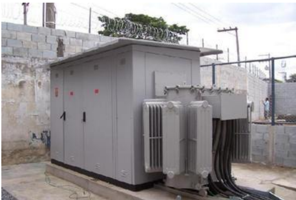
Figura 16: Subestação blindada com transformador externo.
