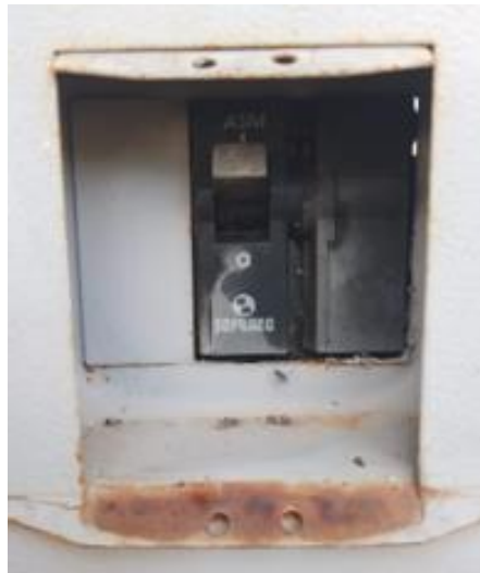
Figura 6: Disjuntor do medidor de energia.
