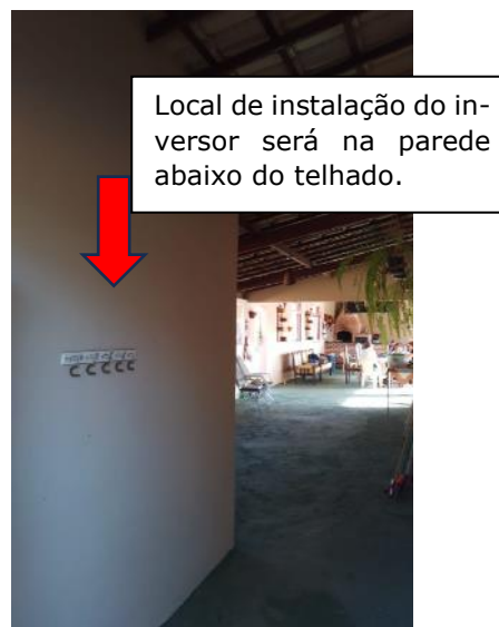
Figura 7: Local de instalação do inversor.
