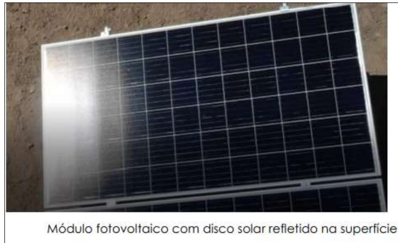
Figura 66: Módulo Fotovoltaico com Disco solar Refletido na Superfície.
