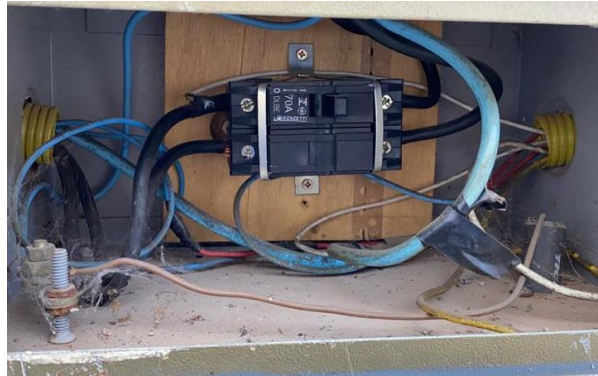
Figura 7: Disjuntor geral da UC.
