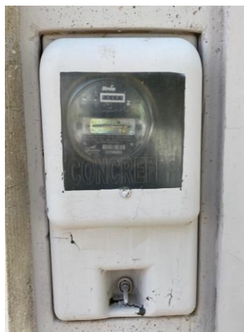
Figura 6: Medidor de energia da UC.
