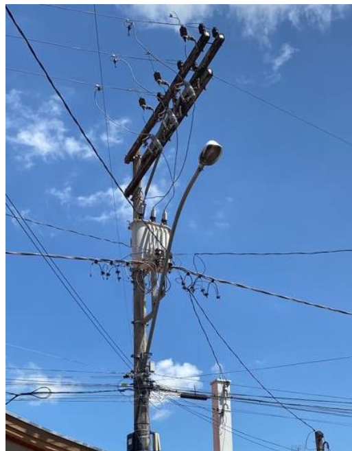
Figura 4: Transformador de alimentação.
