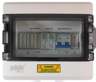
Figura 9: Quadro de proteção CA.
