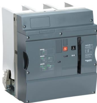
Figura 18: Disjuntor MT existente na subestação.
