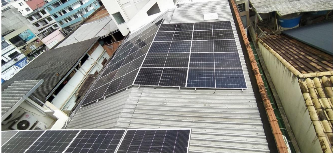
Figura 17: Módulos Fotovoltaicos Instalados no Telhado Norte-Sul.
