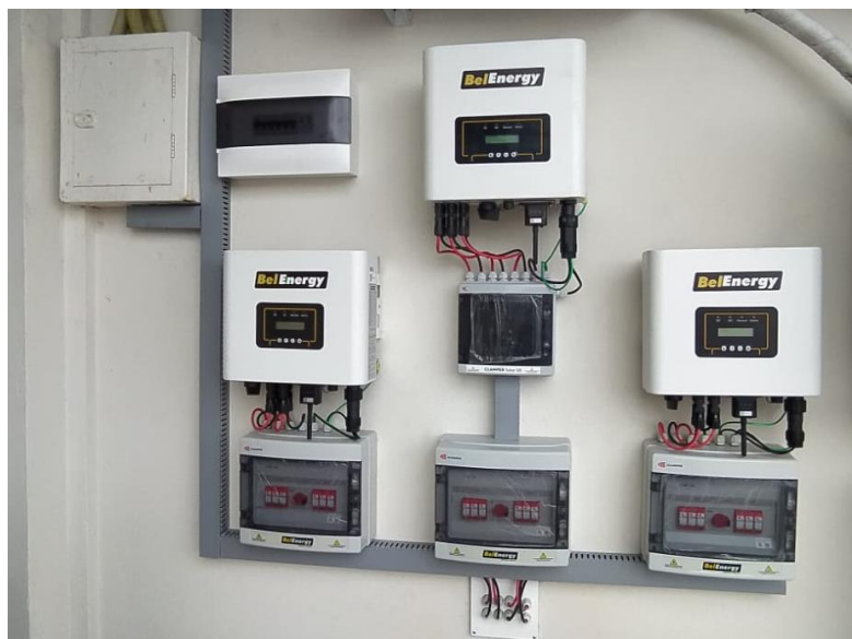
Figura 19: Inversores, String Box DC e String Box AC instalados.
