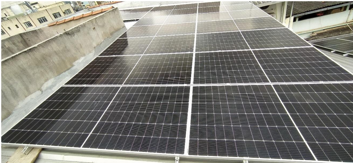
Figura 18: Módulos Fotovoltaicos Instalados no Telhado Leste.
