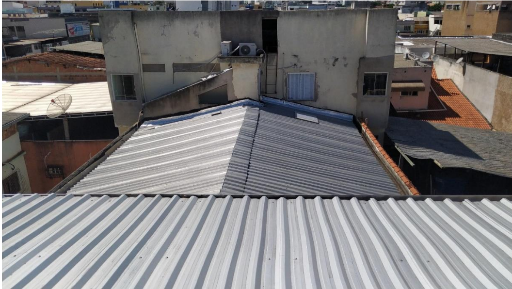
Figura 2: Área de Instalação dos Módulos Fotovoltaicos.
