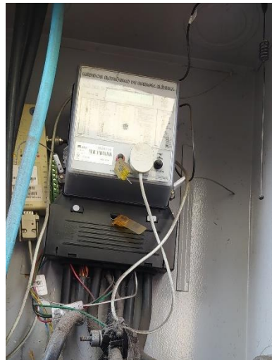
Figura 4: Medidor da Unidade Consumidora.
