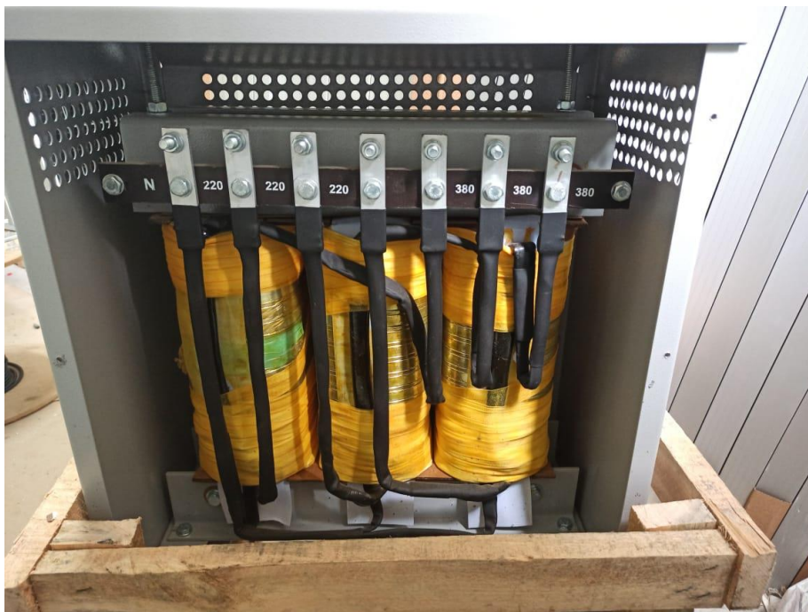
Figura 6: Transformador a seco instalado da usina.
