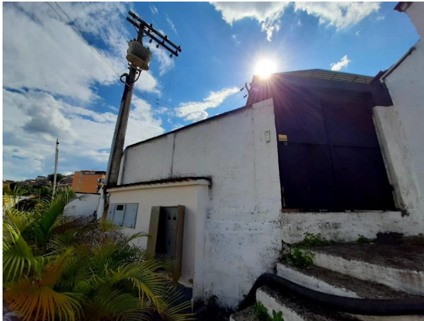
Figura 3: Padrão e poste com transformador da unidade consumidora.
