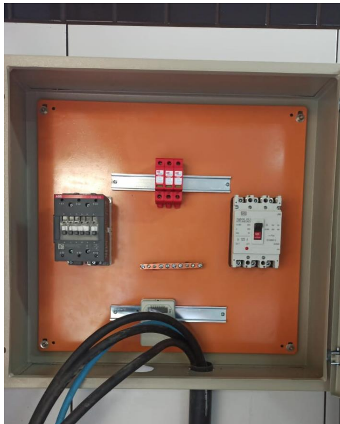
Figura 7: Quadro de proteção do lado de baixa do transformador e controle do transformador.
