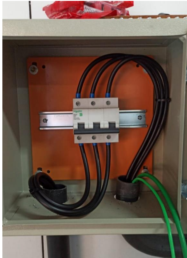
Figura 8: Quadro de proteção do lado de alta do transformador.
