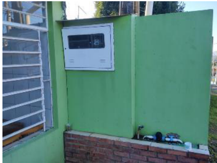
Figura 3: Medidor de energia da UC.
