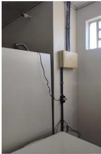
Figura 5: Local de instalação do inversor.
