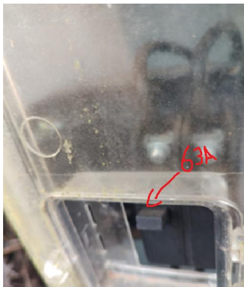
Figura 4: Disjuntor do medidor de energia.
