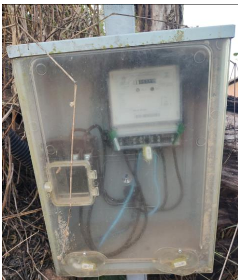
Figura 3: Medidor de energia da residência.
