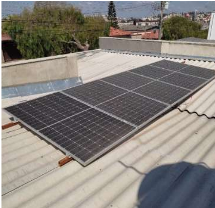
Figura 3: Local de instalação dos módulos fotovoltaicos, voltados para o norte geográfico.
