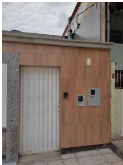
Figura 4: Medidor de energia da UC.
