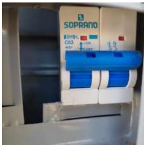
Figura 5: Disjuntor do medidor de energia.
