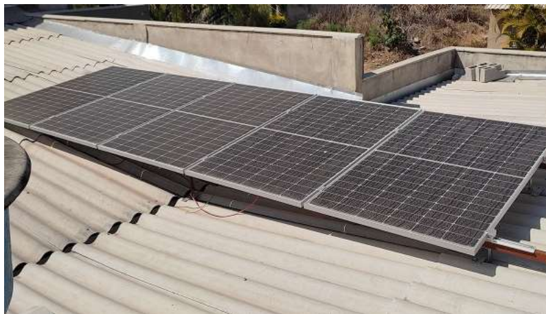
Figura 7: Posicionamento dos módulos fotovoltaicos.
