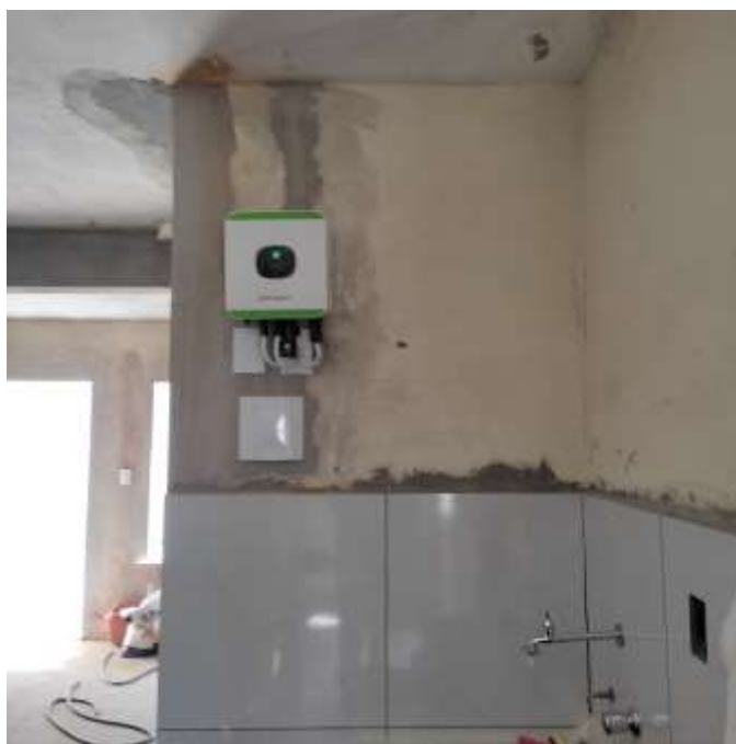
Figura 6: Local de instalação do inversor.
