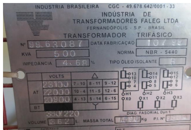
Figura 18: Plaqueta de identificação de transformador existente.
