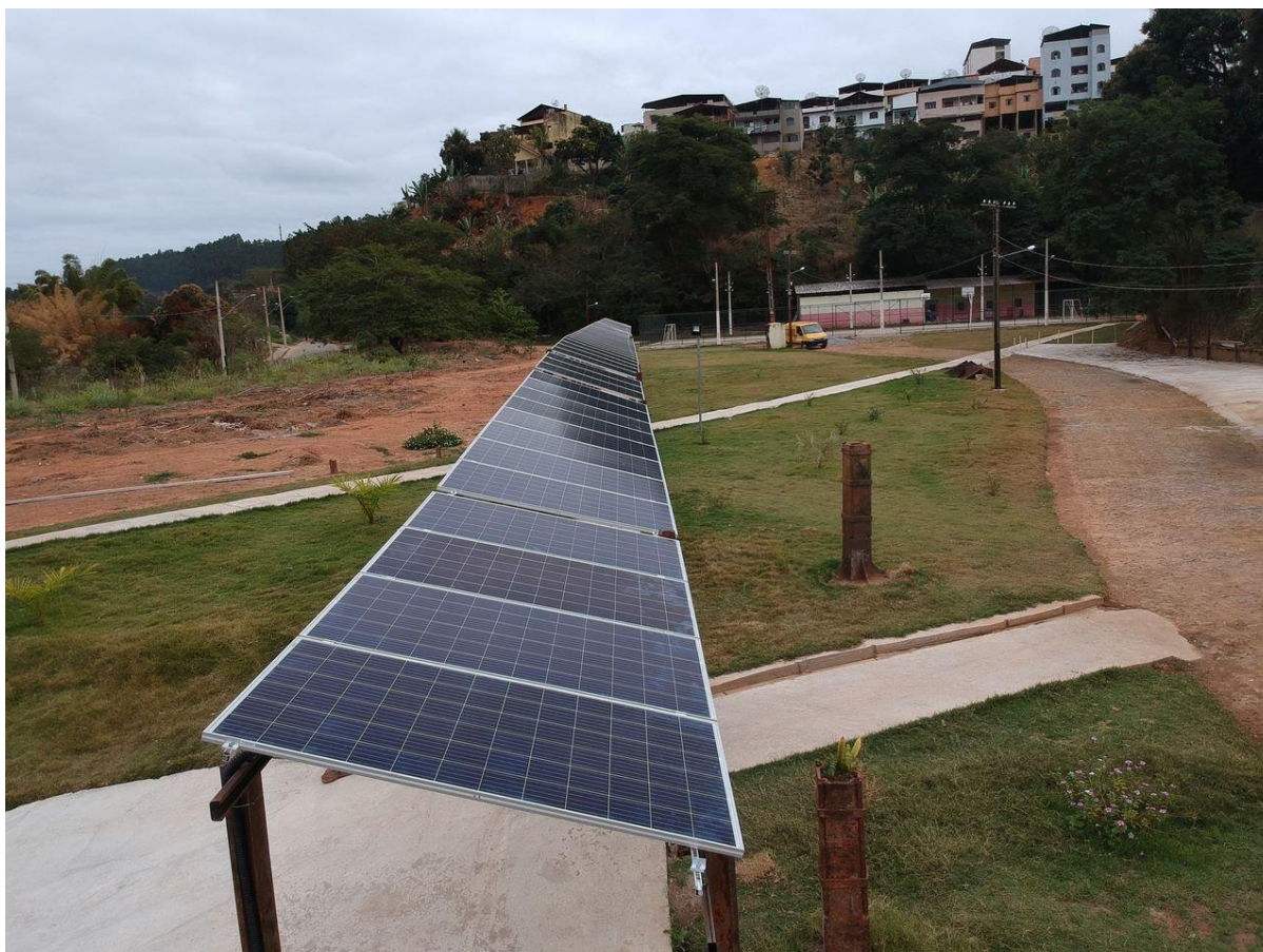
Figura 4 - Usina à época de instalação, agosto de 2019
