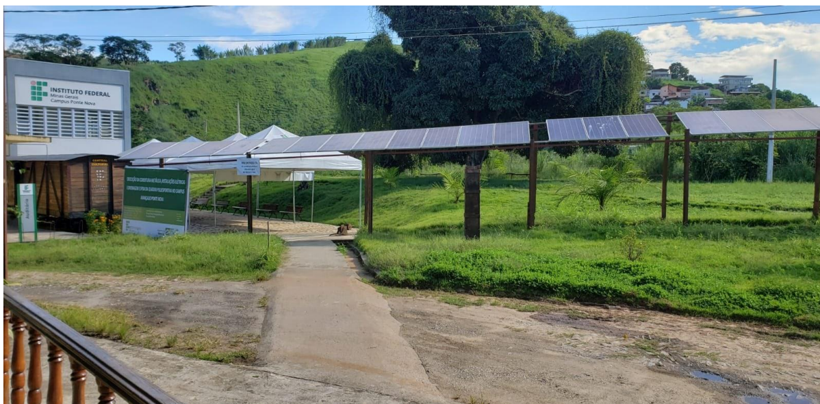
Figura 6 - Usina fotovoltaica, dezembro de 2021.
