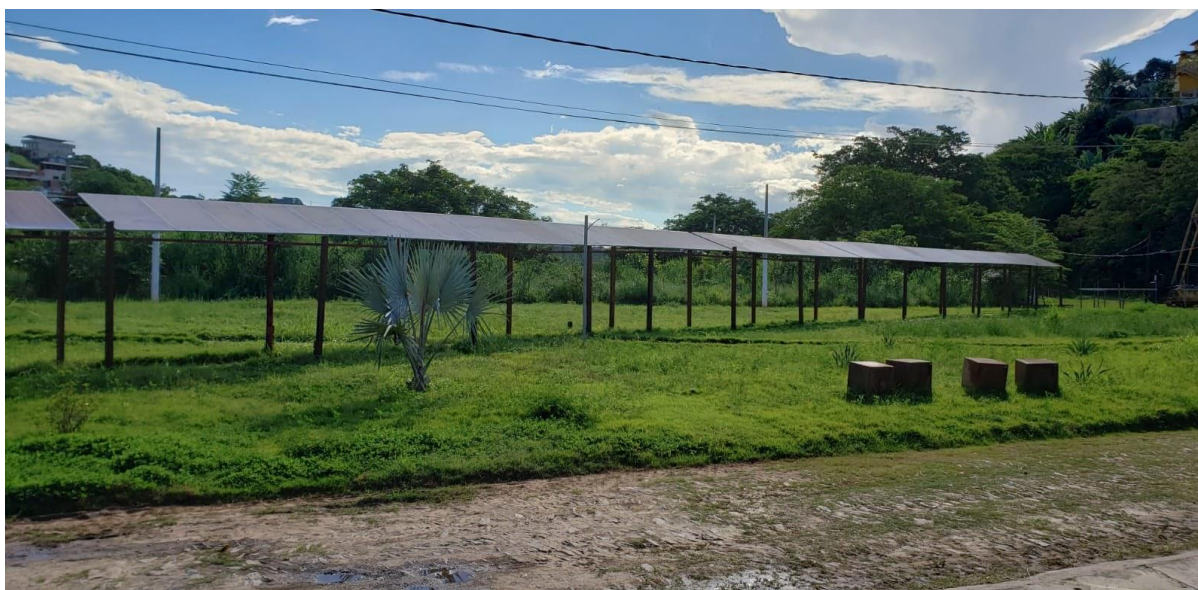
Figura 7 - Usina fotovoltaica, dezembro de 2021.
