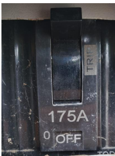
Figura 10 – Disjuntor do padrão de entrada
