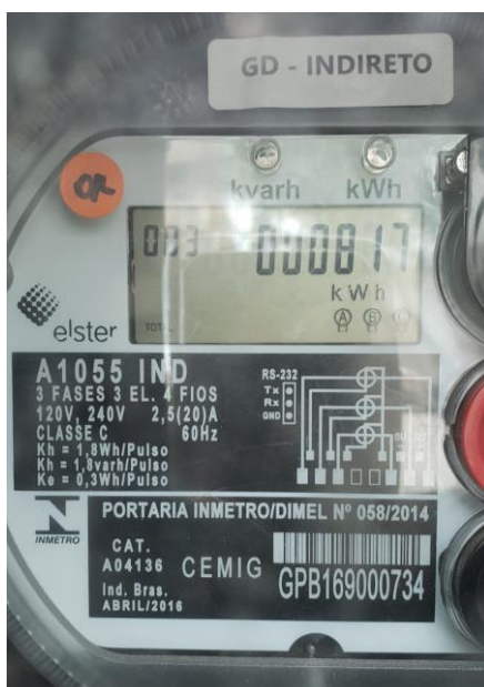
Figura 9 – Medidor bidirecional existente
