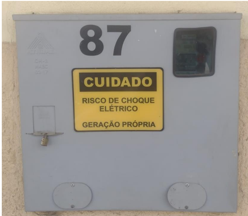
Figura 24 – Padrão de entrada de energia existente, já com medidor bidirecional e disjuntor de 175A
