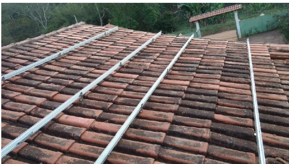
Figura 18: Trilhos de alumínio onde serão colocados os MFV. Fonte: [6].
