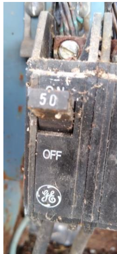
Figura 7: Disjuntor do medidor de energia.
