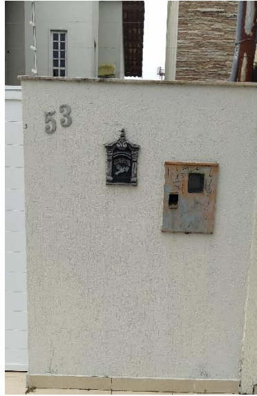
Figura 6: Medidor de energia da UC.
