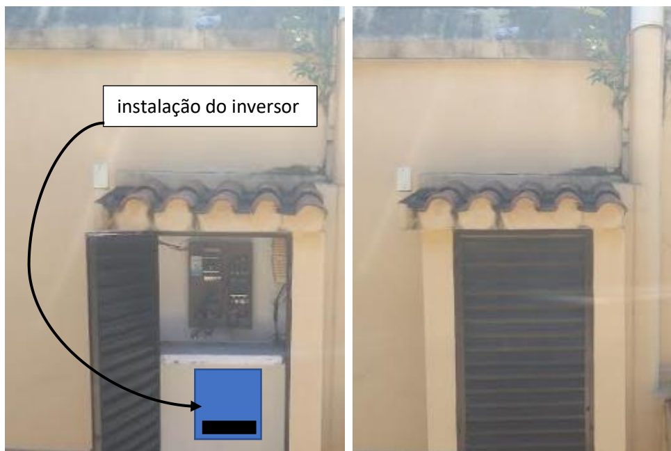
Figura 9: Local de instalação do inversor.
