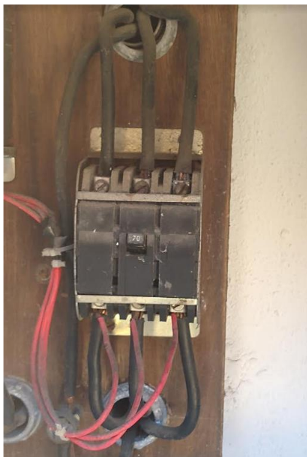
Figura 8: Disjuntor do medidor de energia.
