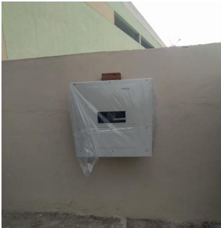
Figura 12: Local de instalação do inversor da Usina Fotovoltaica (UF) 02.
