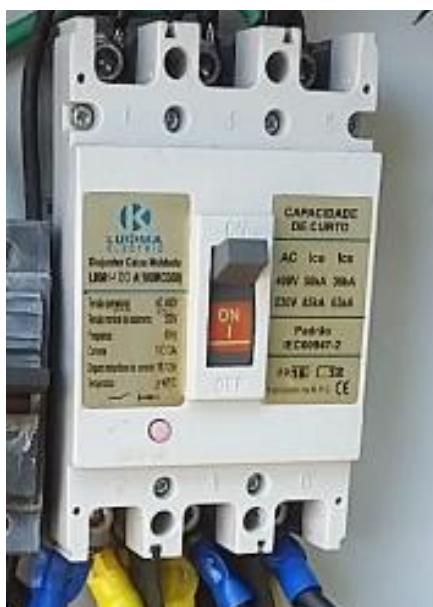
Figura 9: Disjuntor do medidor de energia da UC 01.
