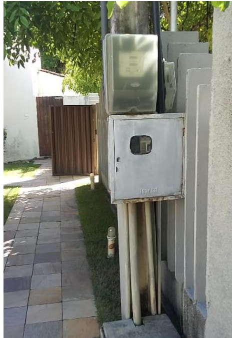
Figura 7: Medidor de energia da UC 01.
