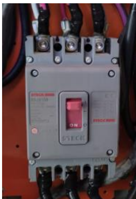
Figura 10: Disjuntor do medidor de energia da UC 02.
