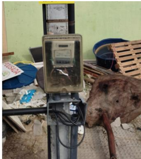
Figura 8: Medidor de energia da UC 02.
