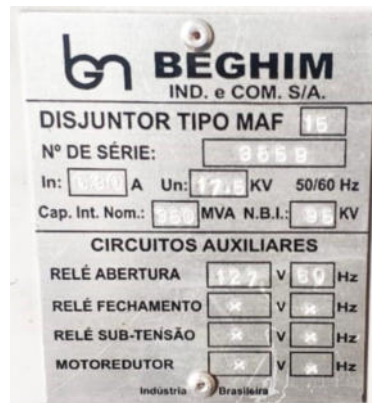
Figura 21: Disjuntor do padrão de entrada da unidade consumidora.
