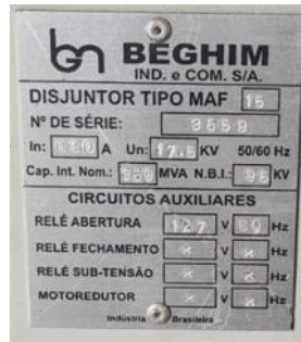
Figura 12: Plaqueta do disjuntor de entrada
