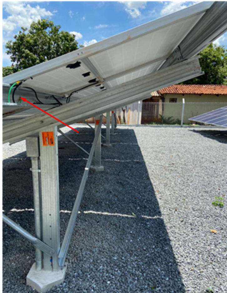
Figura 11: Condutor de aterramento do arranjo fotovoltaico
