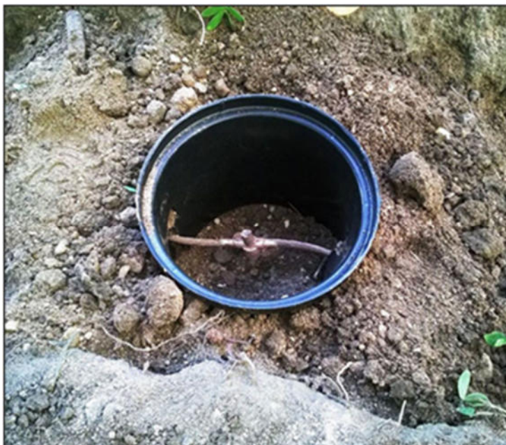
Figura 13: Caixa de inspeção com haste de aterramento
