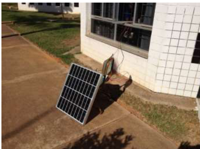
Figura 28: Posição do painel solar ao sol para coleta dos dados.
